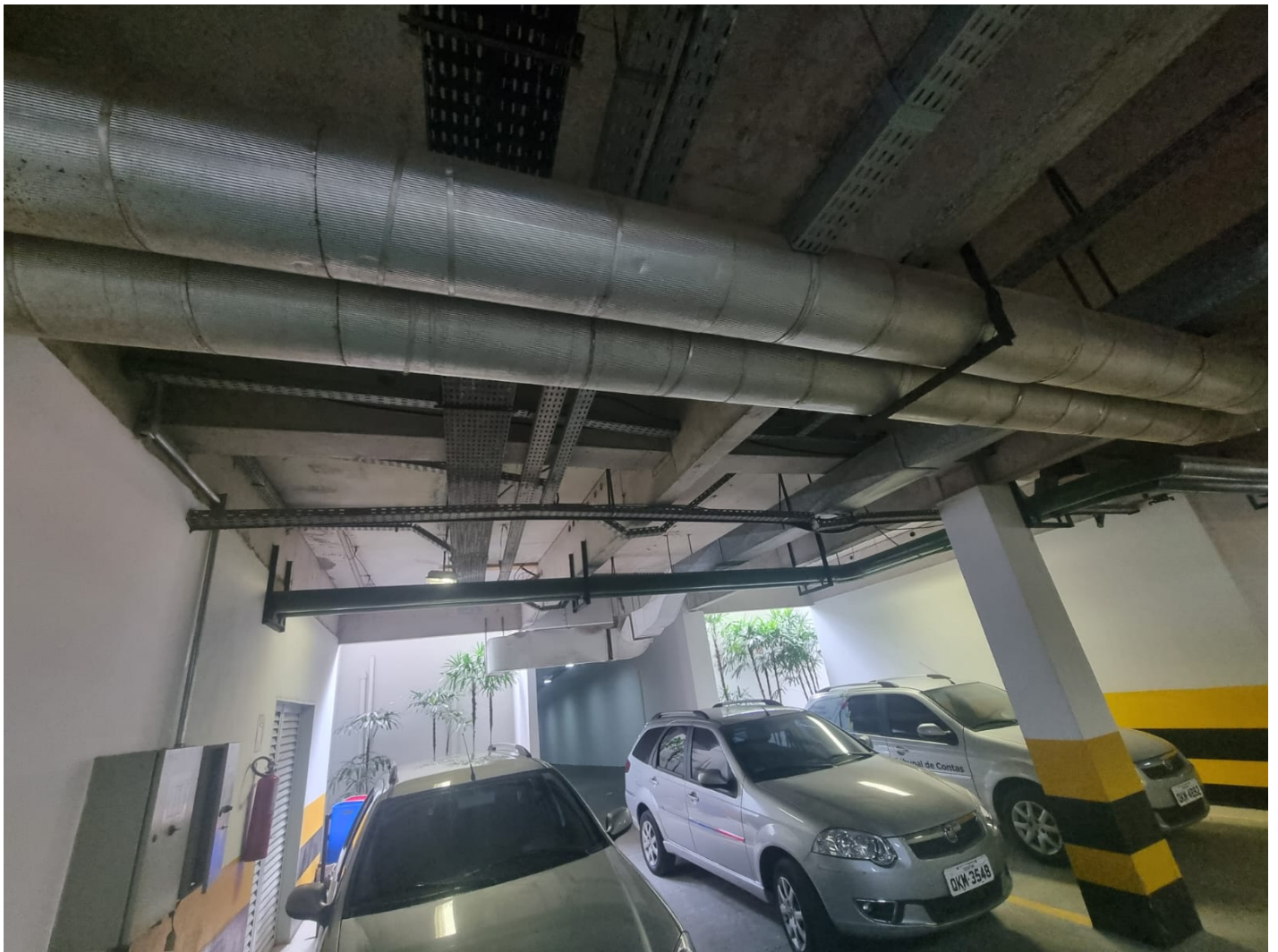
Imagem 2: Tubulação de água fria
