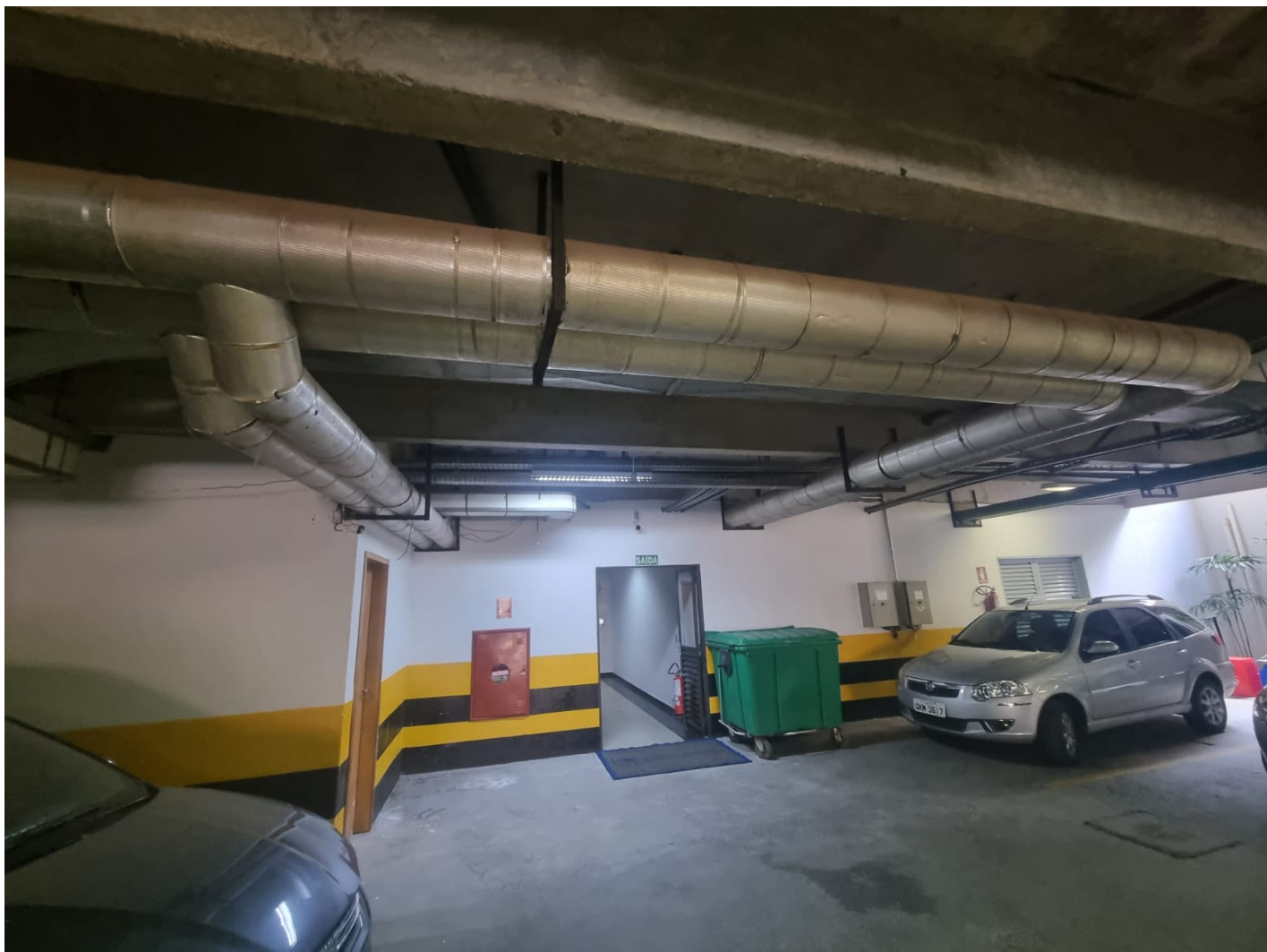
Imagem 3: Tubulação de água fria
