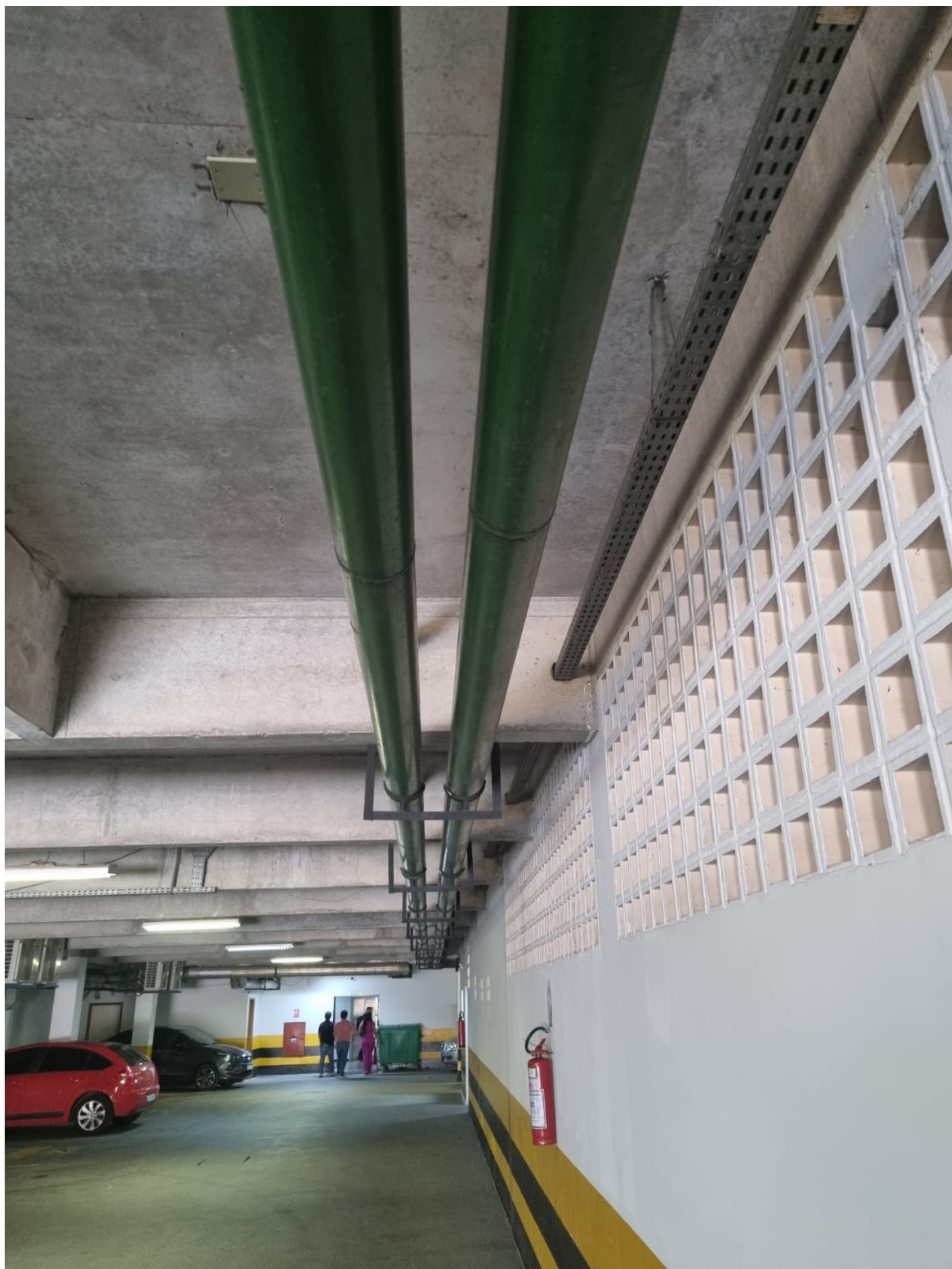
Imagem 4: Tubulação de água quente
