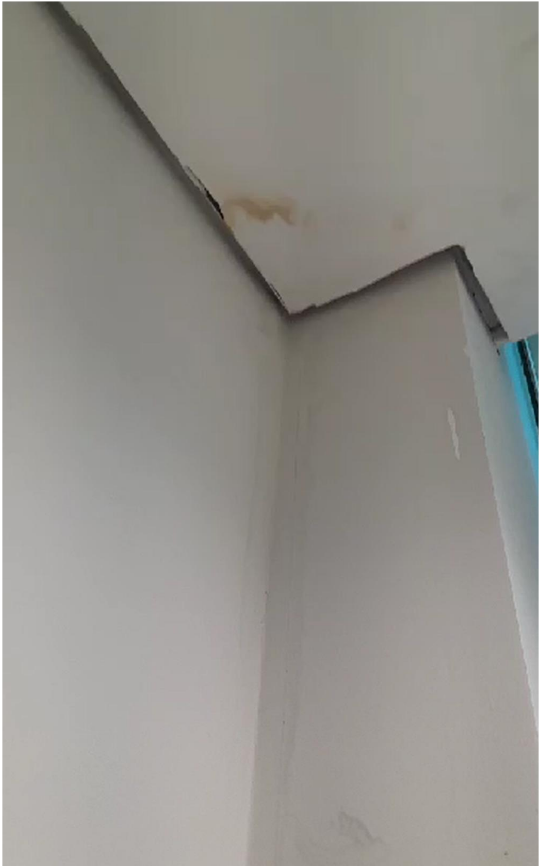
Imagem 02: Infiltrações Ruy Barbosa.
