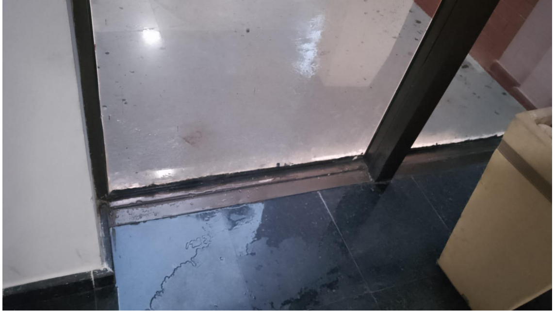
Imagem 07: Infiltrações Edifício Sede.
