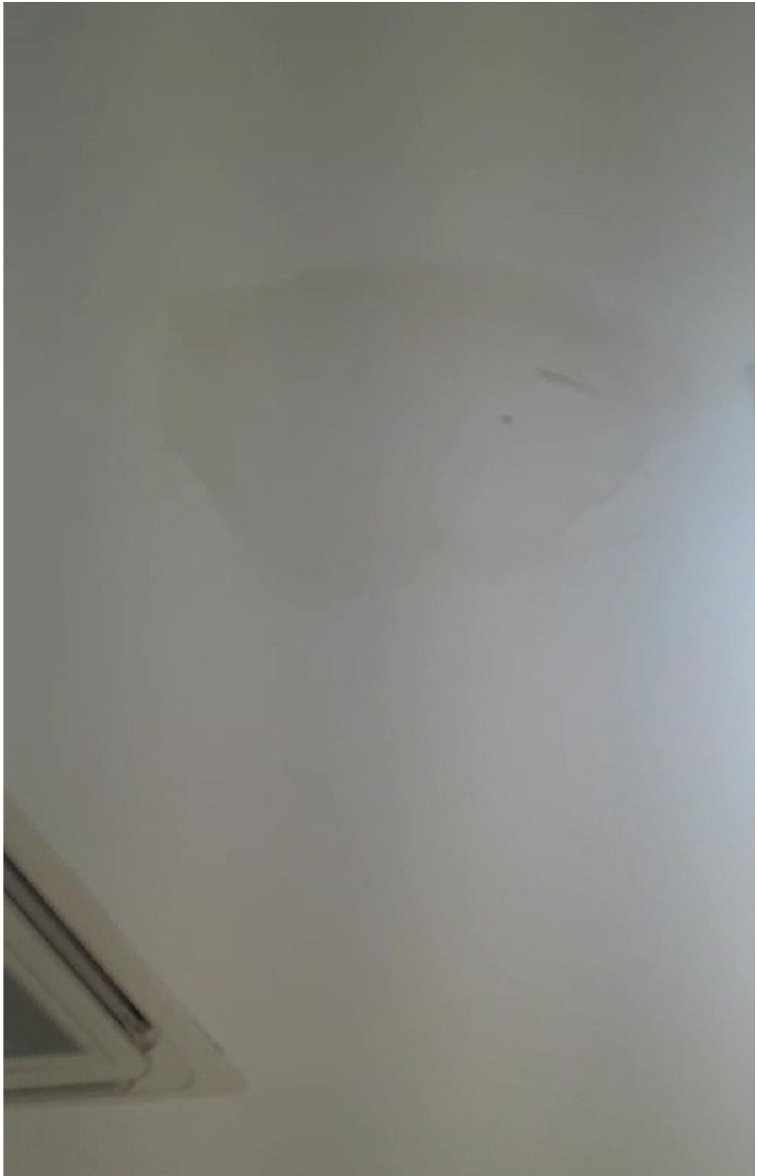
Imagem 01: Infiltrações Ruy Barbosa.
