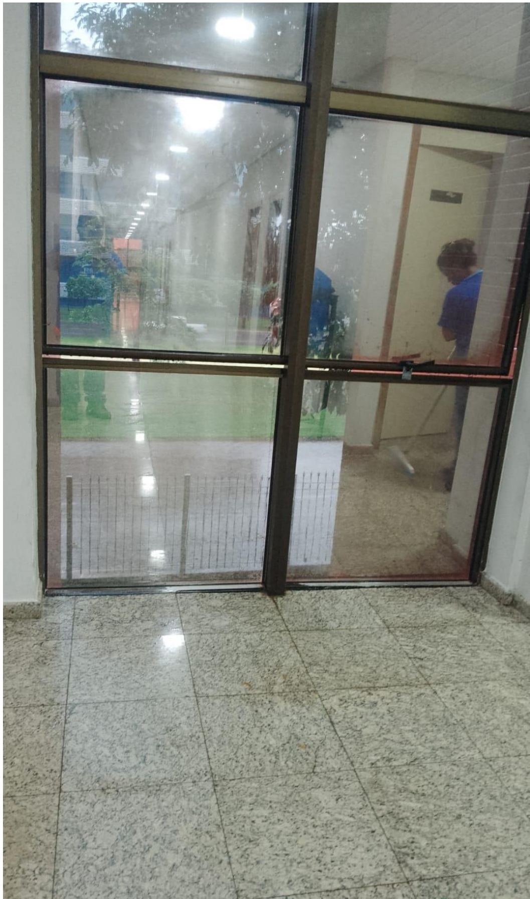
Imagem 05: Infiltrações Edifício Sede.
