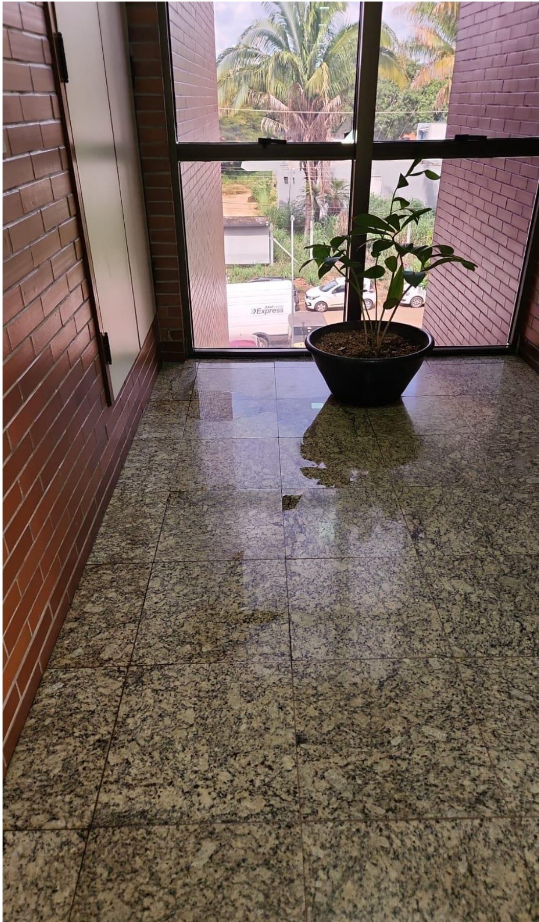
Imagem 04: Infiltrações Edifício Sede.
