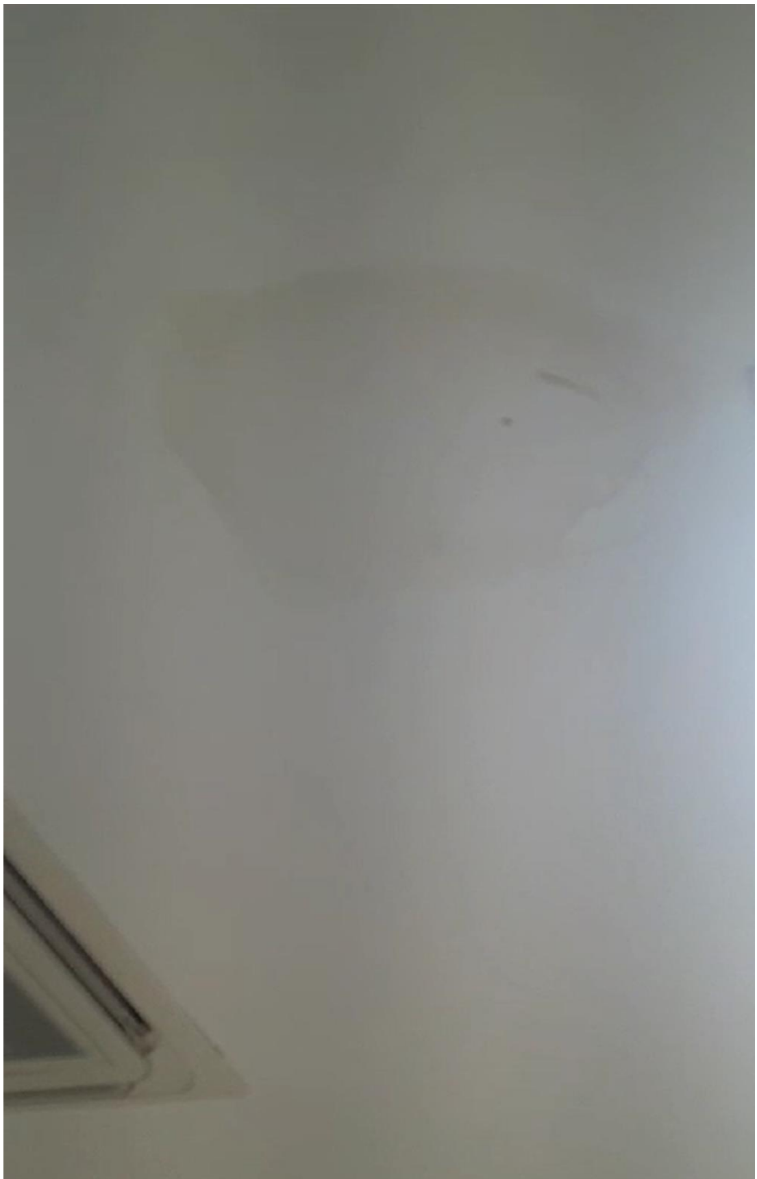
Imagem 01: Infiltrações Ruy Barbosa.
