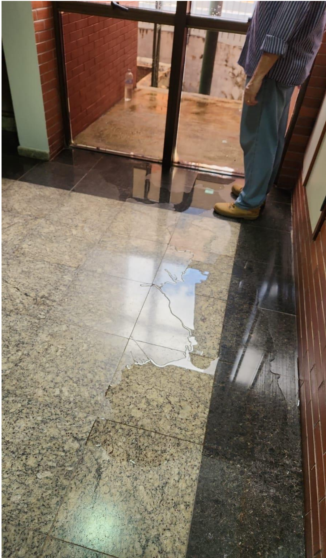
Imagem 06: Infiltrações Edifício Sede.
