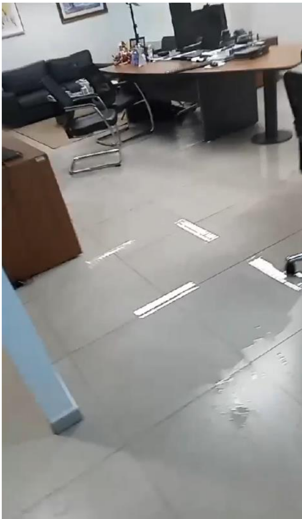
Imagem 03: Infiltrações Ruy Barbosa.
